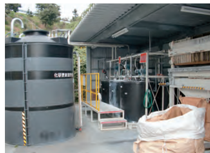
汚水処理施設
